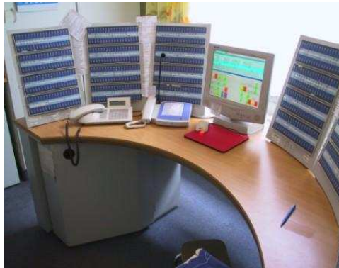
Bild der Schwesternrufanlage
